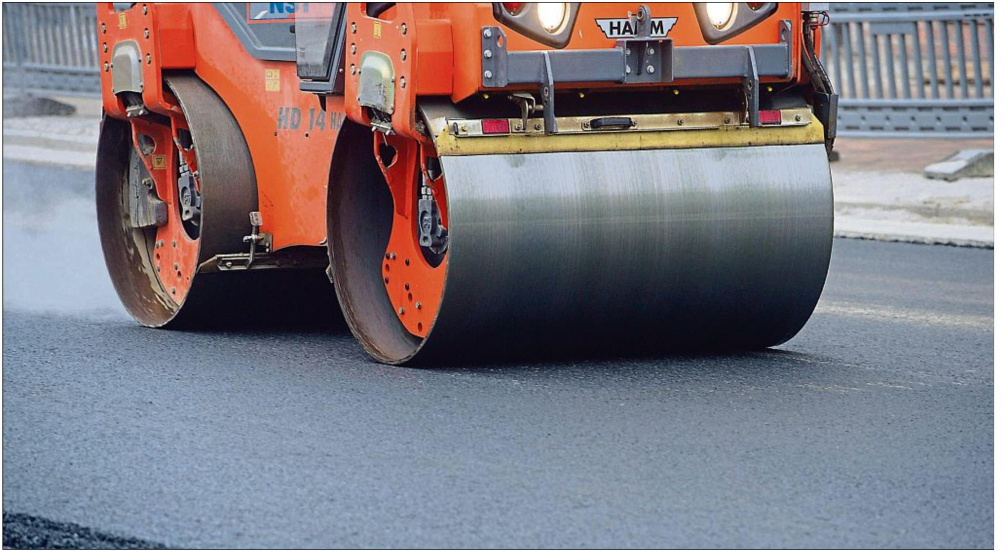
Bei der Vergabe von Straßenbauarbeiten kam es zu einem Kalkulationsirrtum.
