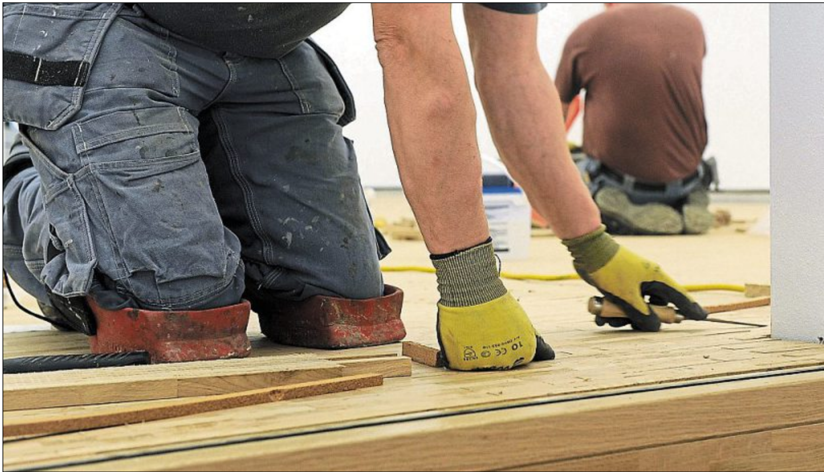
Um die Vergabe von Bodenbelagsarbeiten gab es Streit.
